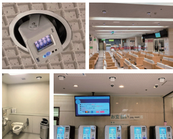
天井に設置されたCare222® iシリーズ トイレ（左）自動精算機周辺（右）
