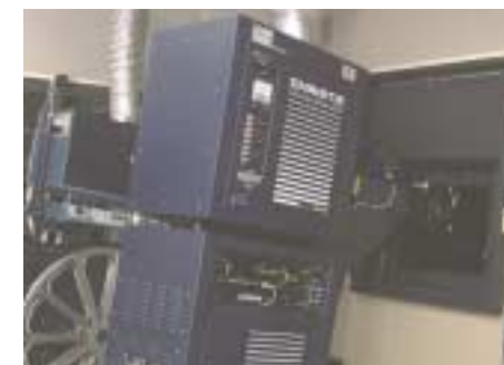
シネマ・コンプレックス「京成ローザ」館内(上)とDCP-Hが設置された映写室(下)
